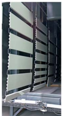
Bei Angelier- und Einbrennofen reduziert eine Doppelschleuse den Wärmeverlust, sodass die Türen nur bei speziellen Anforderungen geschlossen werden müssen.
